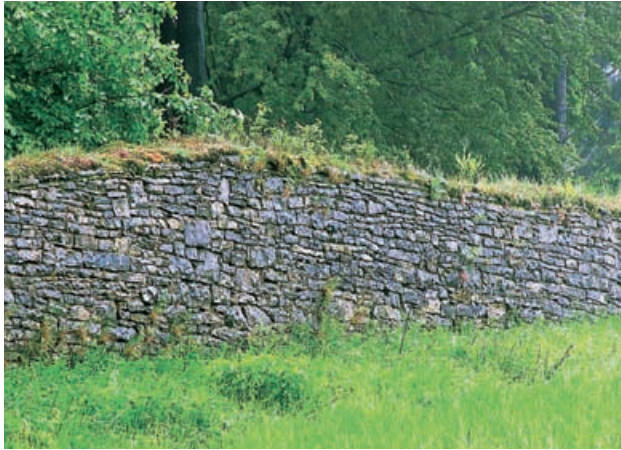
Abb. 5: In den 1980er Jahren wurde ein Mauerabschnitt auf dem Nesselberg vor- bildlich mit Kalkmörtel und einer Abdeckung aus Rasensoden saniert Foto: Lara Diekmann (Hannover)
